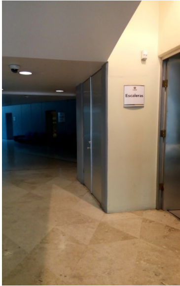
Figura 4: Las escaleras tienen que ser anunciadas con un rótulo debido a la poco pertinente solución arquitectónica
