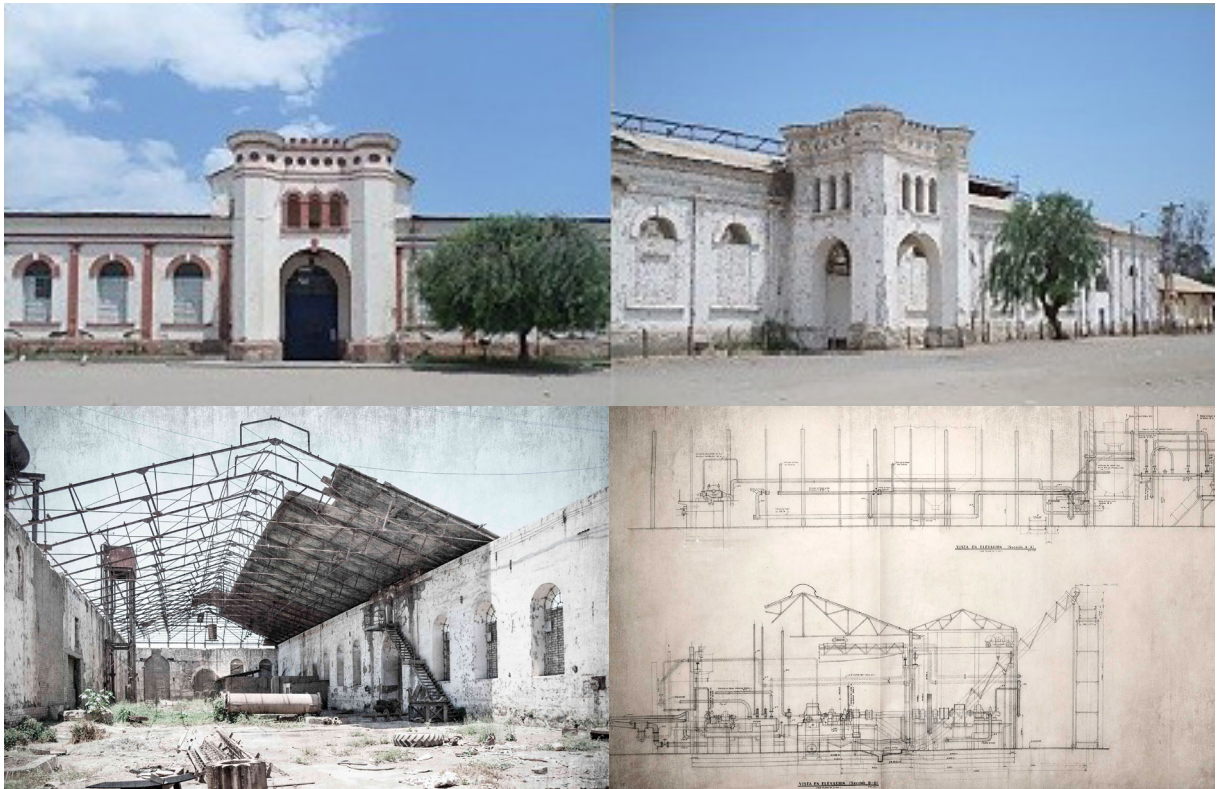
Figura 3: Vestigios de la Planta Industrial Cayaltí. Autores (2024), a partir de registro fotográfico de Perleche (2017).
