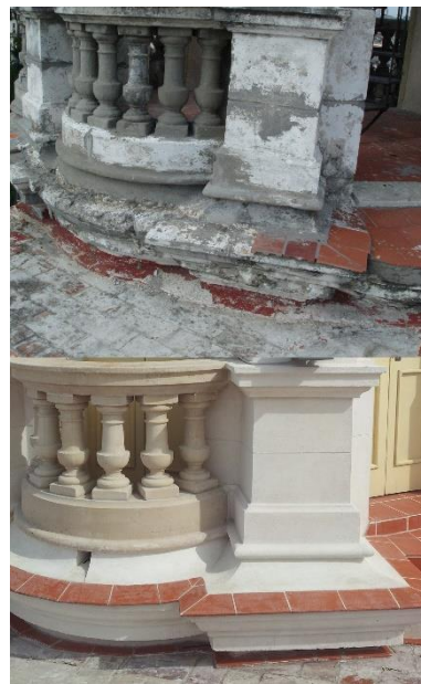
Figura 8: Estado de daños y restauración Fuente: A. Cortiñas, 2012 – 2015
