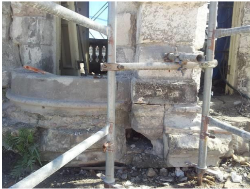
Figura 4: Deterioro de elementos en fachada. Fuente: A. Cortiñas, 2014.
