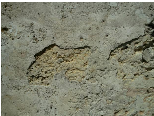
Figura 5: Pérdida del revestimiento. Fuente: Sergio R. Arencibia, 2015.
