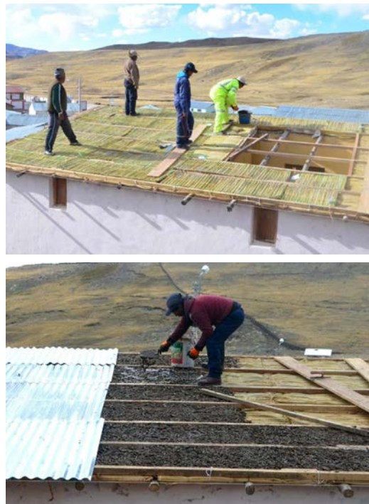
Figura 8: Detalle de la ampliación de la claraboya del vestíbulo-invernadero (arriba) y adición de capa adicional de tierra alivianada y plancha ondulada impermeable en la cubierta del prototipo
