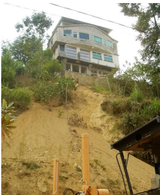
Foto 3. Vivienda ubicada sobre ladera que ya presenta desgajamiento (López, 2011).
