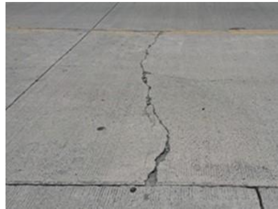
b) Agrietamiento en la vía abscisa 48+800
